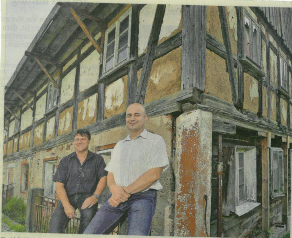
Ein Lichtblick für eins der ältesten Häuser von Obergurig: Die Gemeinde veranlasst jetzt die Notsicherung des Umgebendehauses. Bürgermeister Thomas Polpitz (r.) und Bauhofleiter Udo Brosig sind froh darüber.
